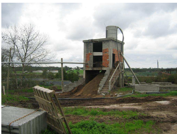
Fotografia 3.21 - Tanque de receção e separador de sólidos.
